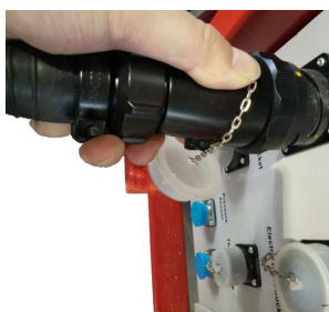
电热板连线与电气箱的连接
